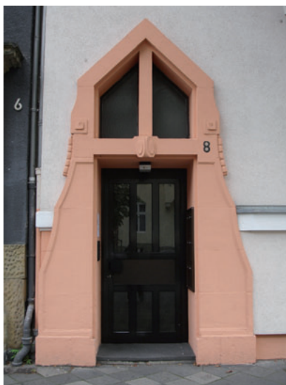
Nachträglich eingebaute Aluminiumtür in einer auffälligen Jugendstilfassade
